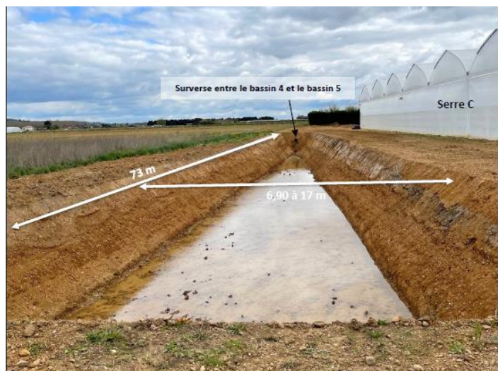
Bassin d'infiltration n°5 (Cliché : Monsieur TOPPAN)
